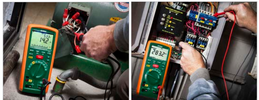
Comprobación del voltaje en un torno y prueba de aislamiento en el motor de la bomba.
